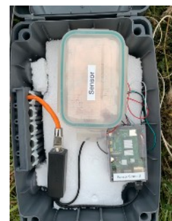
(Bild 17: Der Inhalt der Box am Ende des Kabels in dem KG-Rohr)
